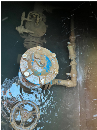
Fuite dans la chambre de régulation de pression _ Bréchaumont
