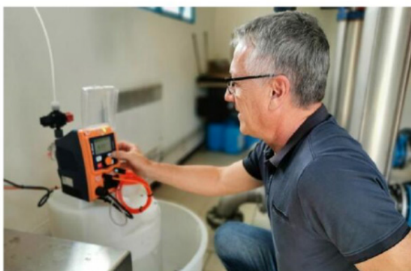
Les membres du syndicat intercommunal d'alimentation en eau potable (SIAEP) de Bréchaumont et environs ont adopté à l'unanimité la mise en place d'une chloration constante du réseau. Ici, Philippe Trommenschlager, président, à la station de pompage. Photo C.A.
